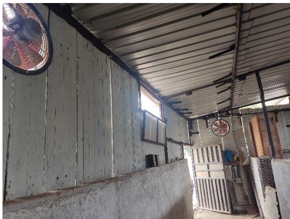
Figure 3.4 : Systèmes de ventilation et d'éclairage. (photo personnelle)
