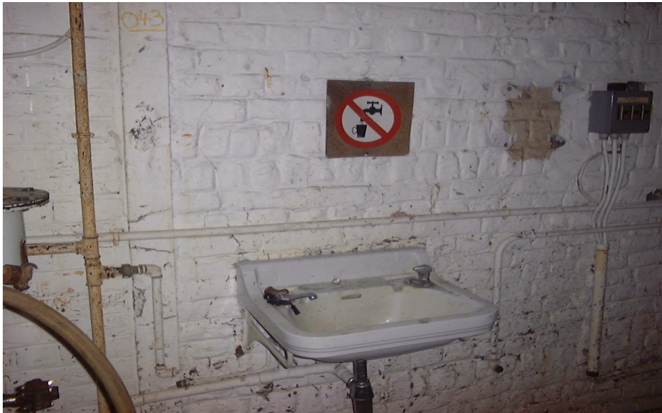
Figure 9 : absence d'eau potable, mauvais état des murs. (Anonyme)
