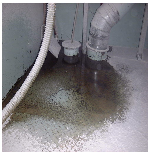
Figure 6 : mauvaise inclinaison du sol, stagnation d'eau. (Anonyme)
