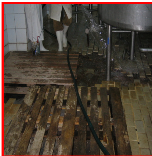
Figure 5 : mauvais état du sol, présence de palette en bois. (Anonyme)
