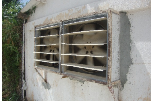
Figure 20 : Ventilation par extraction dans le bâtiment 1
