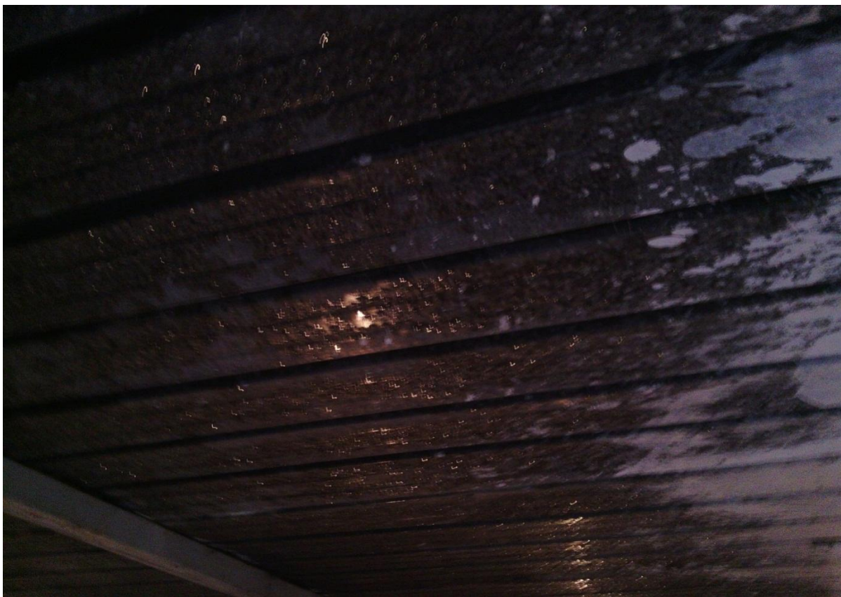
Photo 3 : Humidité sur le plafond (photo personnelle)
