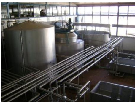
Figure 2 : Cuve de préparation (Photo personnelle)
